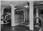
Fig. 14. Installation de chauffage par réfrigération. A gauche, deux échangeurs de chaleur. Au milieu, tableau de contrôle et de commande. A droite, pompes de circulation.
